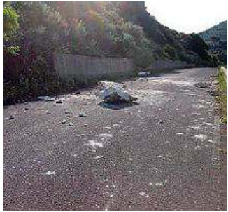
La strada chiusa per la frana
